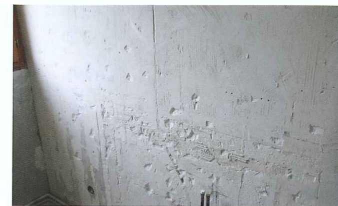
Les dégradations laissées par la dépose des revêtements céramiques seront reprises afin de retrouver un support propre, sec et sain.
